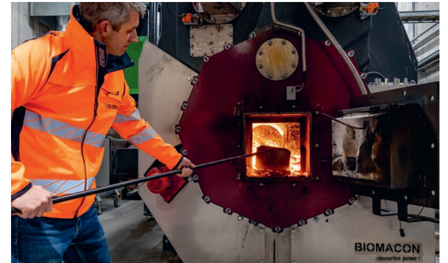
In diesem Ofen – der Pyrolyseanlage – wird aus Holzschnitzeln Pflanzenkohle hergestellt.
